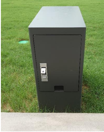
電源、上水道外観
